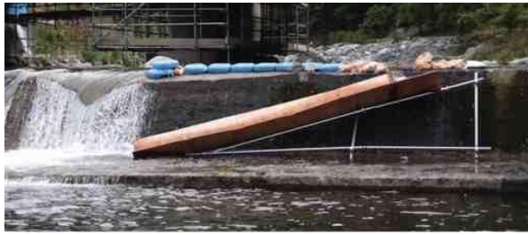
a) 設置状況
